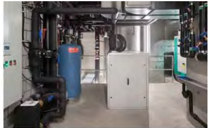
Innenansicht Küche Hautechnikzentrale BSR_07_1007_AF017
